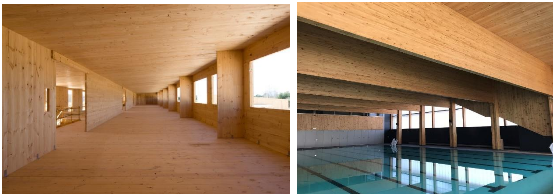
Ilustración 1. Edificio de CLT (Cross Laminated Timber), y cubierta con vigas de MLE (Madera Laminada Encolada)
